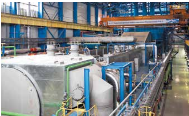
Машинный зал первой очереди Южноуральской ГРЭС-2
